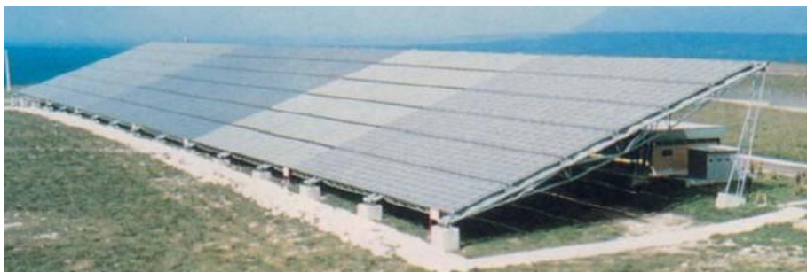
Figura 7 – Esempio di impianto stand-alone: Centrale di Monte Aquilone Fonte Enea
